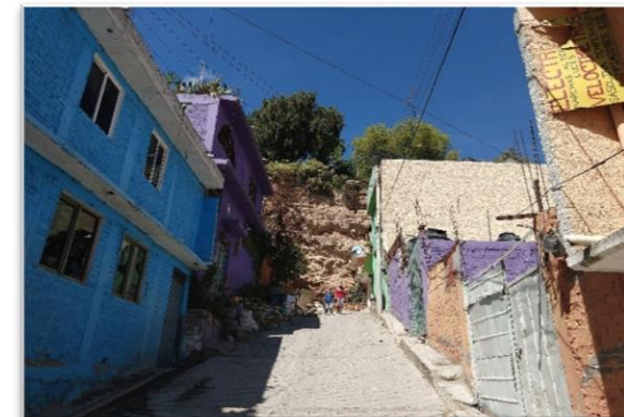
Foto 18 Casas con posible afectación por desprendimiento de material del talud.
