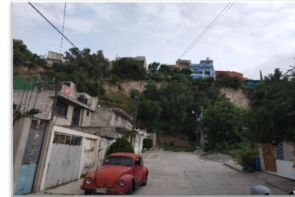
Foto 24 Zona de riesgo Col. Benito Juárez, casas en corona y pie del talud.
