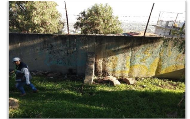
Foto 35 Vista de perfil en dirección sur de la zona de desprendimientos.
