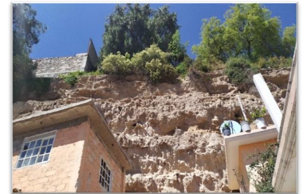
Foto 17 Cárcavas y huecos en la cara del talud y casa descansando sobre esta.
