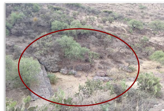
Foto 22 Gaviones Dañados por los Flujos ocurridos en la zona.
