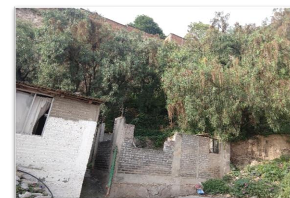
Foto 13 Domicilios afectados en la base del talud.
