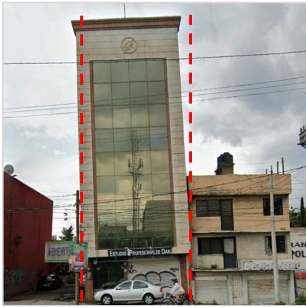
IMAGEN: EJEMPLO DE DESPLOMES VISIBLES A SIMPLE VISTA EN INMUEBLES DE AV. CENTRAL.
